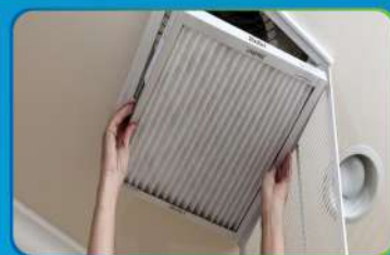
Ensure cleaning of AC filter एसी फिल्टर की सफाई सुनिश्चित करें
